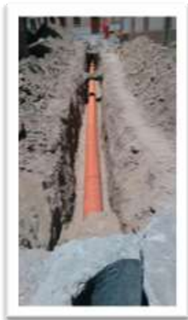
Es importante el saneamiento y renovación de la red de abastecimiento y desagües
